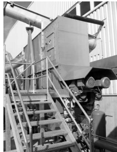
„Dosierer“ zur Anreicherung des aufbereiteten Bioabfalls mit Presswasser auf einen Wassergehalt von ca. 73%
