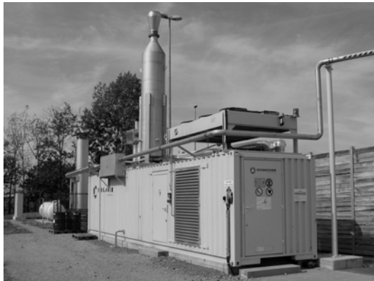
Blockheizkraftwerk mit Abgasfackel
