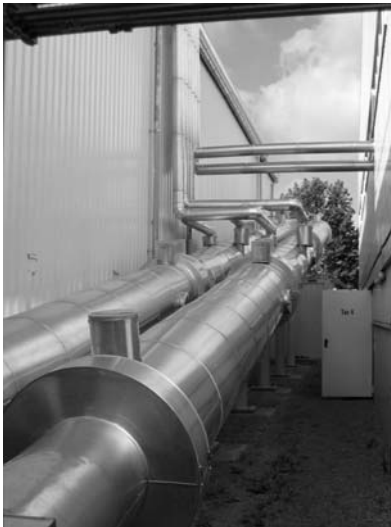
Wärmetauscher zur Vorerhitzung des Gärsubstrates vor dem Eintrag in den Fermenter
