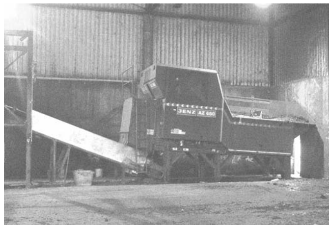
Überbandmagnet und Steigband zum Separator
