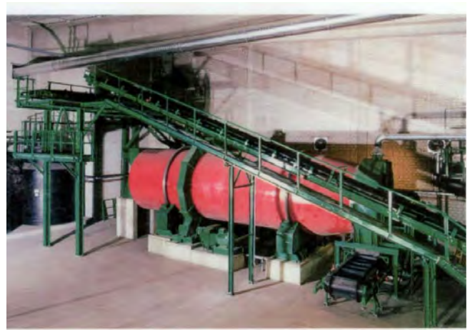
Mischtrommel zur Rotte Vorbereitung
