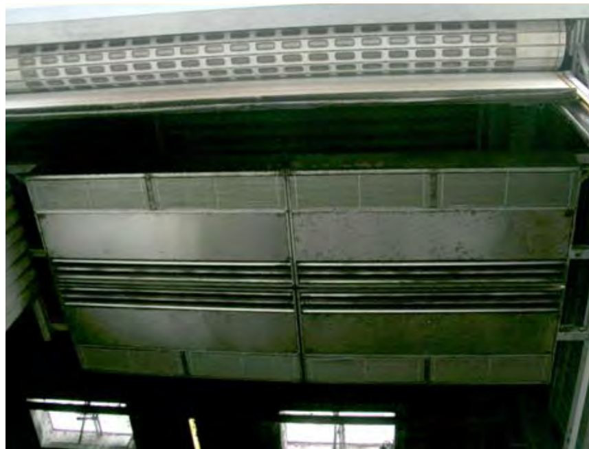
Luftschleieranlage und Rolltor
