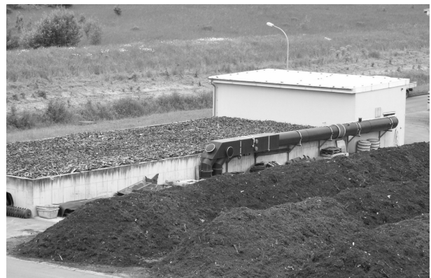
Biofilter zur Reinigung der Abluft mit Gebäude für Ventilatoren
