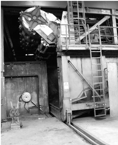
Das Biofix Umsetzaggregat fährt vom Wartungsbereich in die Rottehalle ein und wird auf die erste Rottezeile aufgesetzt
