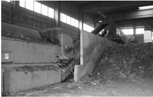
Anlieferungsbereich mit Aufgabebunker für Bioabfälle
